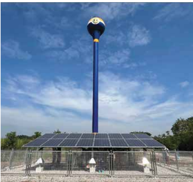
ระบบสูบน้ำบาดาลพลังงานแสงอาทิตย์
