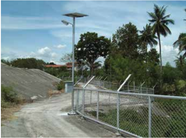
ระบบเสาไฟส่องสว่างพลังงาน
